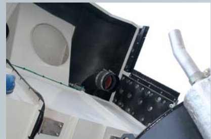
Schalldämmung im Maschinenraum
